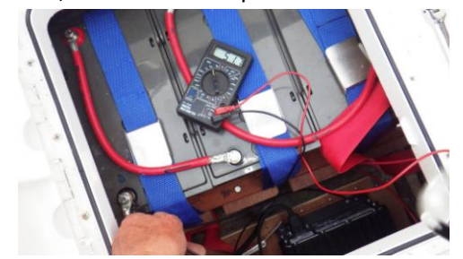
Batteribanken 4 stk 12 V batterier 48 V anbragt under ratplatformen – et ledigt rum, når man har rorvind
